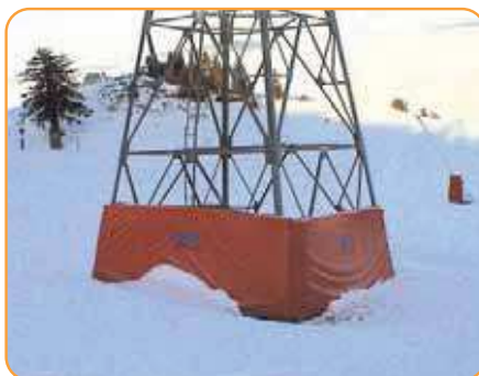
Materassi ad U per la protezione dei piloni
